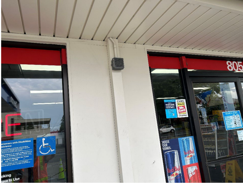
Overfill Alarm no sign
