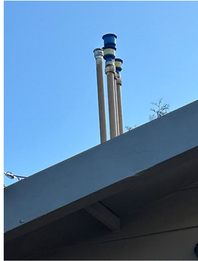
16: Vapor vent caps
