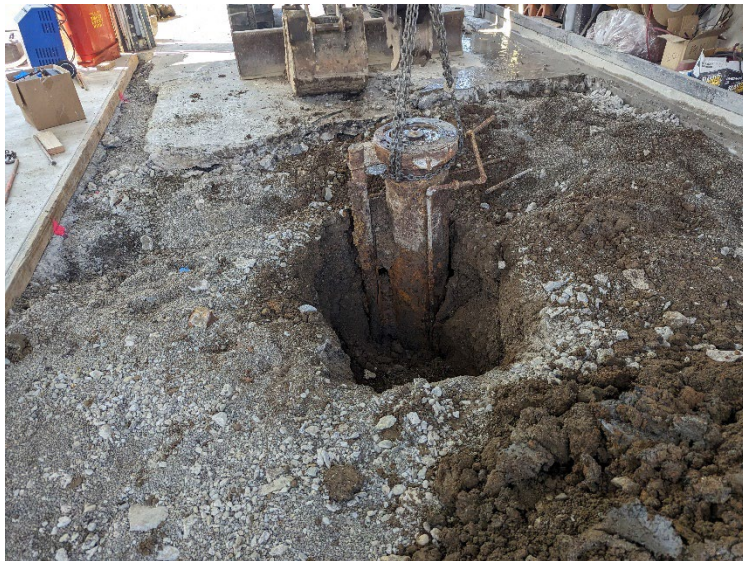
Pulling Hoist H03.
