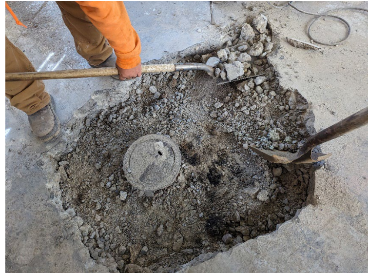
Fill port of UST01.
